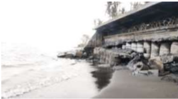
Gambar 10. Rusaknya Talud di Pantai Pabean Sumber : Observasi, 2018
